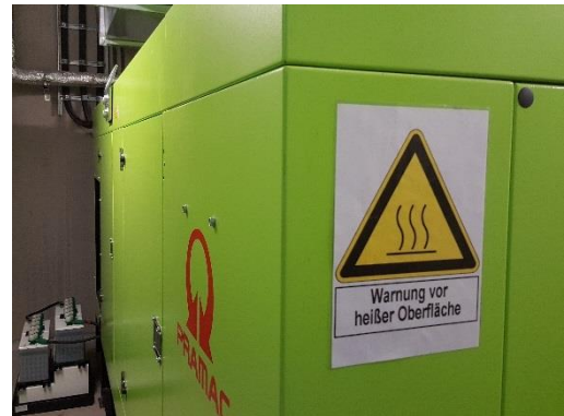
Abbildung 12: Gehäuse der Netzersatzanlage (Quelle: eigene Darstellung)
