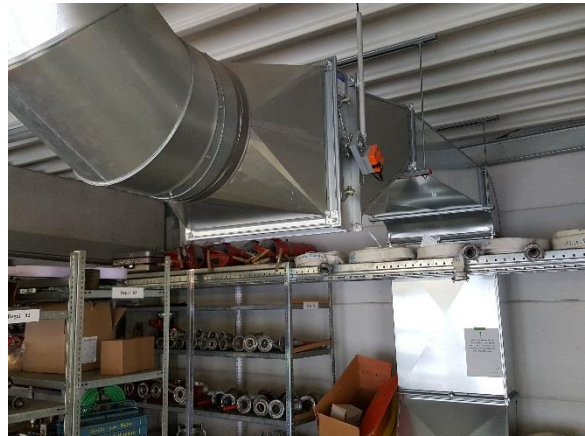
Abbildung 14: Ein zu niedrig angebrachter Lüftungsschacht (Quelle: eigene Darstellung)
