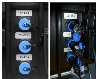
Abbildung 5-10: Beschriftete Kabelverschraubung an der Messbox, eingesteckte Kabelenden in die Kabelverschraubungen
