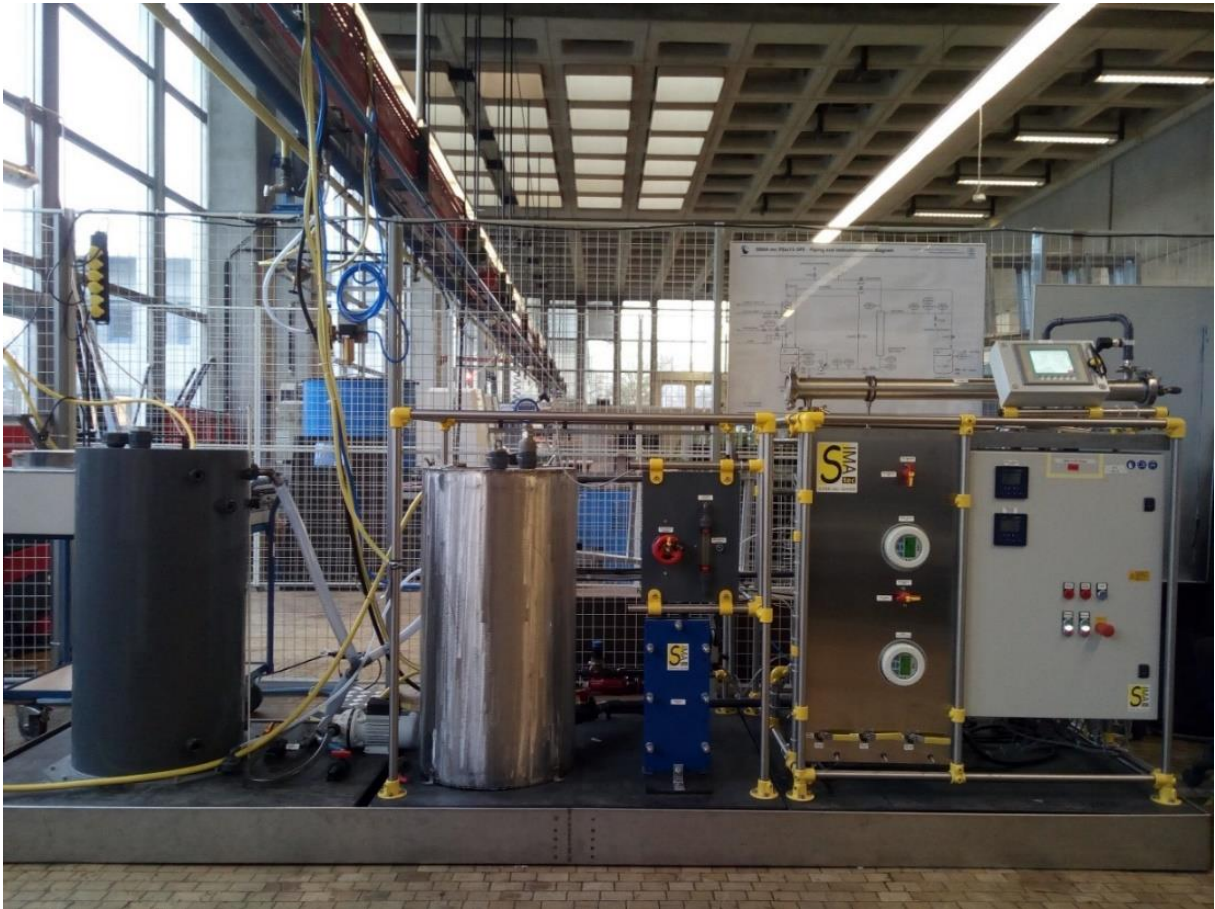
Abbildung 13: Aufbau der Membranfiltrationsanlage „PStal5“
