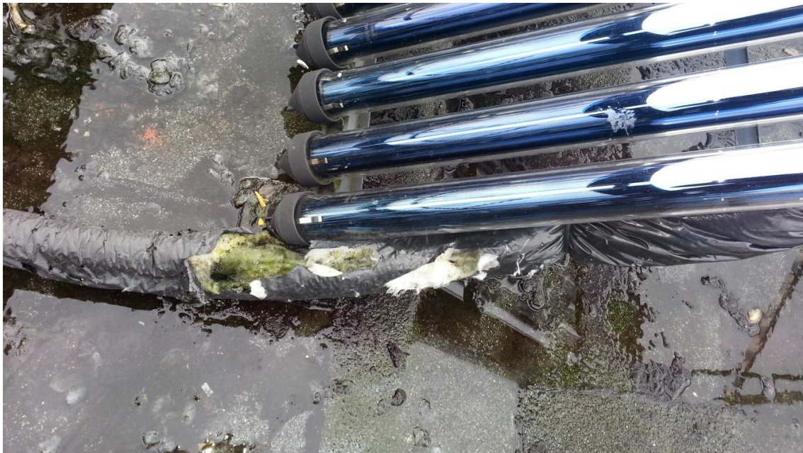
Abbildung 15: Beschädigte und falsch gedämmte Rohrdämmung
