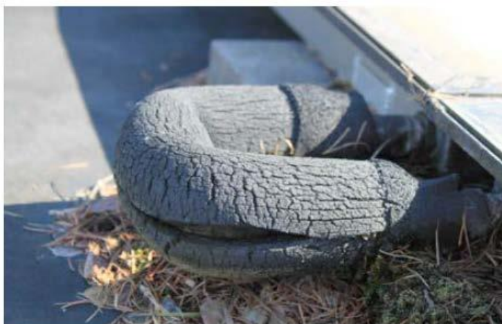
Abbildung 8: Beschädigtes Dämmmaterial durch zu hohe Temperaturen im Vorlauf (Weyres-Borchert & Kasper, 2015, p. 109)
